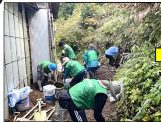
家屋の周りがある溝に土砂が堆積
